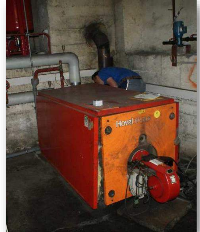
Quelle: Kurs der Kantone Luzern/Aargau „Heizungs-Check“
